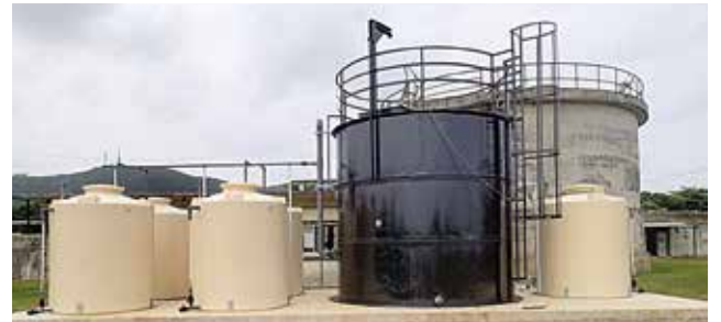
写真② 生ゴミをメタン発酵させる試験用プラント 写真提供：石垣市
