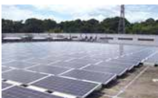
写真⑤ 工場屋上の太陽光パネル
