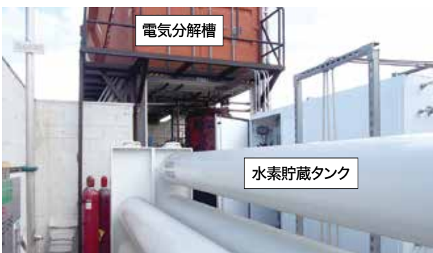
写真② 水素貯蔵タンクは地上にむき出しで、ガス漏れ検知器を設置しているのみ
